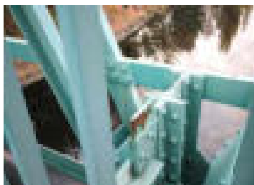
Abb. 60 Korrosion an der Fachwerkskonstruktion
