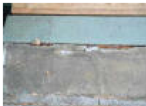
Abb. 61 Betonabplatzungen am Brückenübergang
