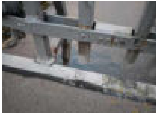
Abb. 47 Korrodiertes Geländer und Betonabplatzungen
