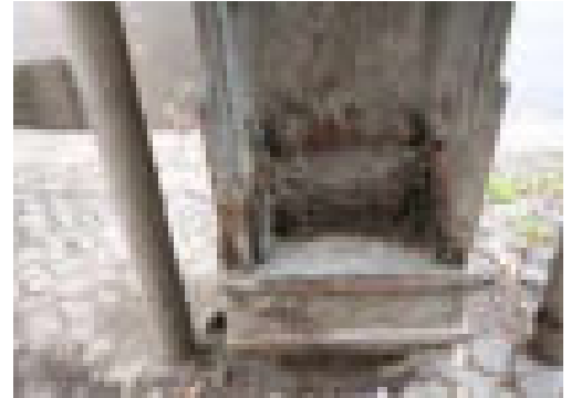
Abb. 137 Korrosion am Pfeiler
