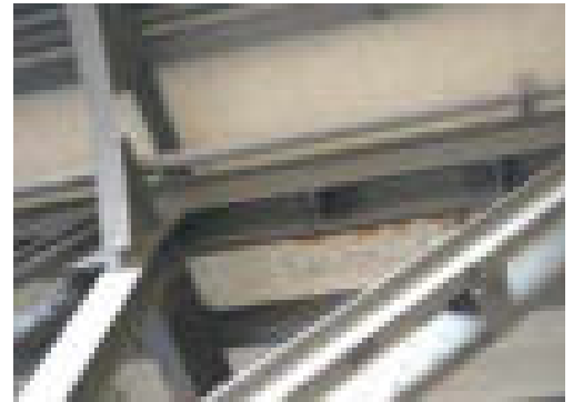
Abb. 46 Rostfahne an der Brückenunterseite
