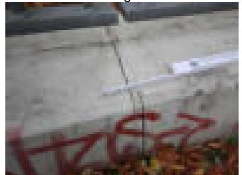
Abb. 105 Gerissene Fugenabdichtung am Gesims
