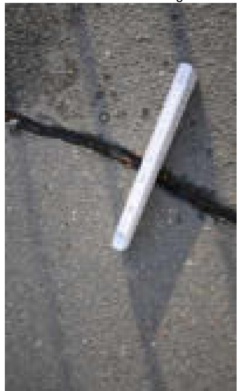
Abb. 118 Riss im Gehwegbelag
