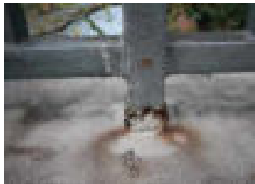
Abb. 54 Korrosion am Geländerfuß
