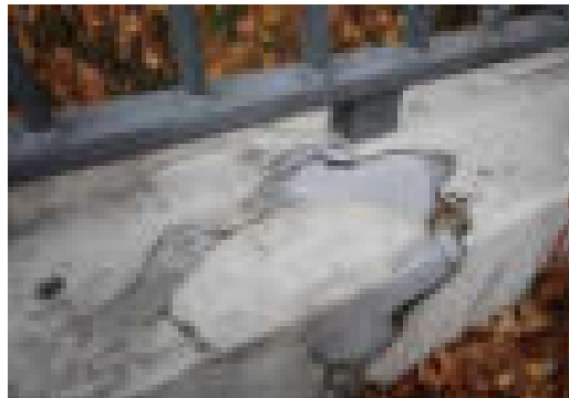
Abb. 104 Schadhafte Oberflächenschutzsystem am Gesims
