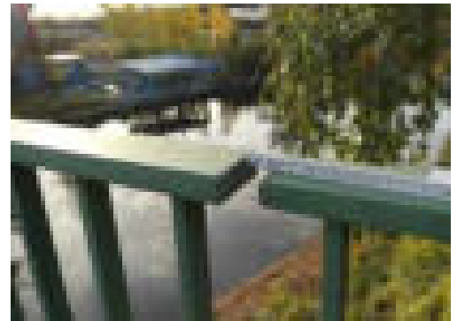
Abb. 98 Verformung am Widerlager
