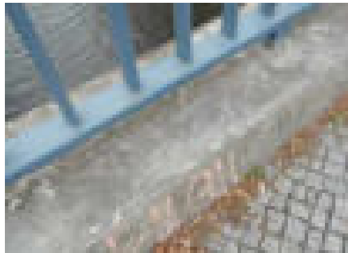
Abb. 130 Schadhafte Oberflächenschutzsystem am Gesims
