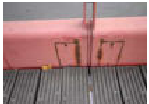
Abb. 78 Korrosion am Überbau
