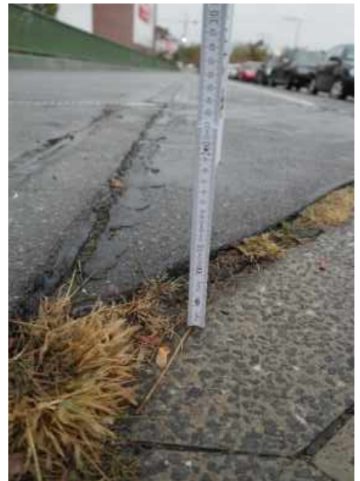
Abb. 102: Unebenheiten am Bau- werksübergang
