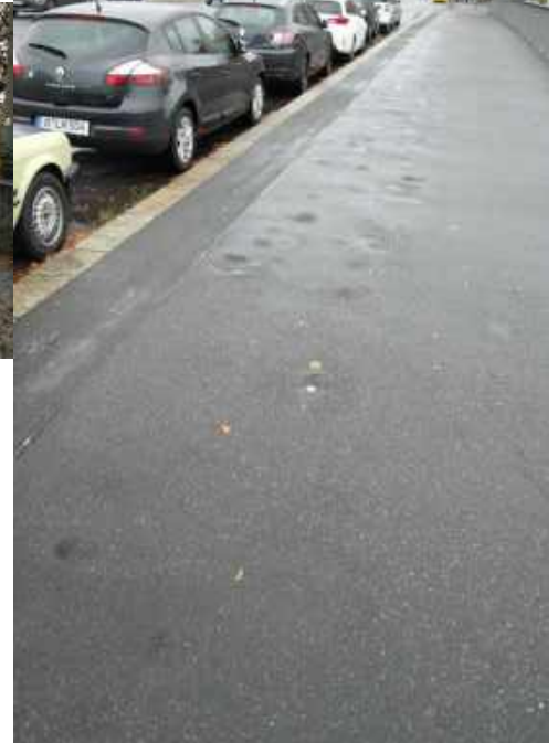
Abb. 114: Blasen im Bereich des Geh- und Radwegs
