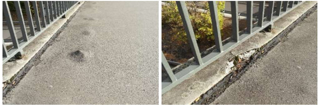
Abb. 16 Belag mit Blasen (links), Betonabplatzungen am Gesims (rechts)
