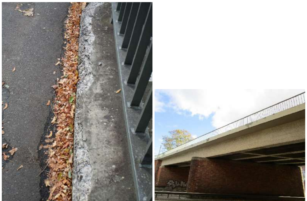
Abb. 21 Abplatzungen am Geländer (links), schadhaftes Oberflächenschutzsystem am Gesims (rechts)
