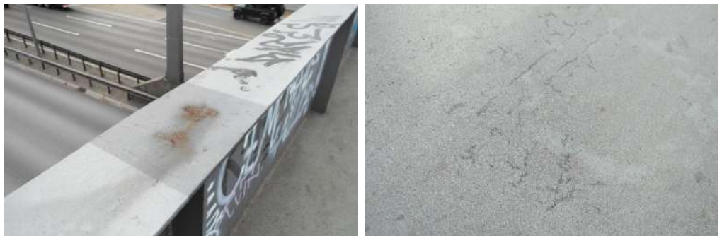
Abb. 13 Korrosionsschäden (links), Rissiger Fahrbahnbelag (rechts)
