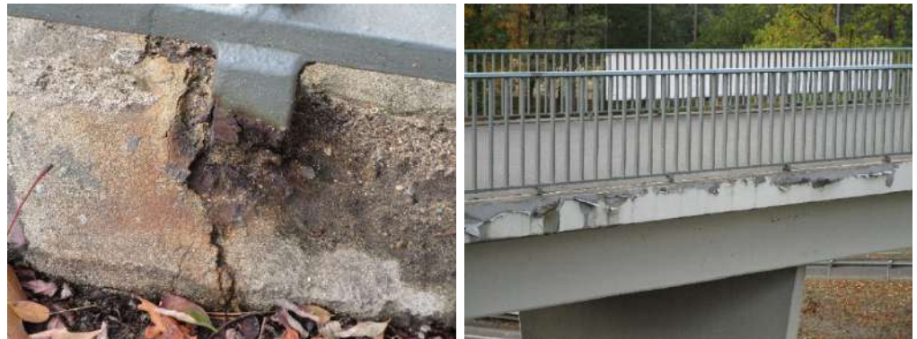
Abb. 17 Korrosionsschäden am Geländerfuß (links), Schadhafte Oberflächenschutzsystem (rechts)
