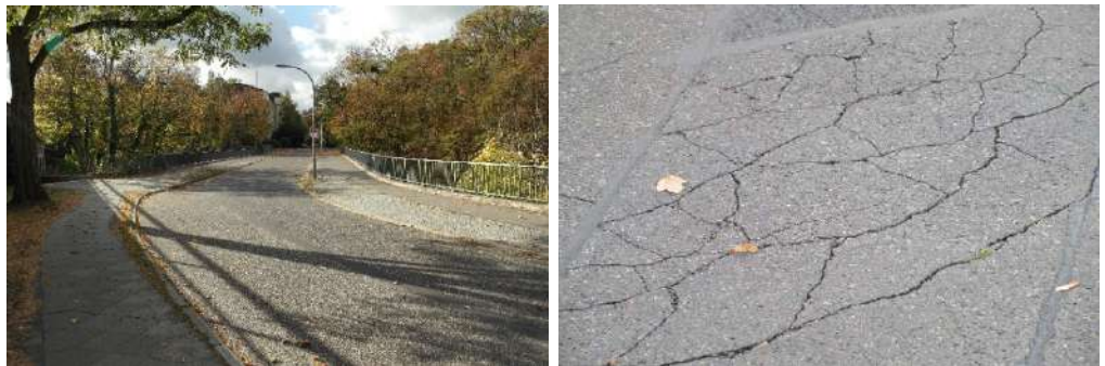
Abb. 20 Fahrbahn und Absturzsicherung (links), rissiger Belag (rechts)
